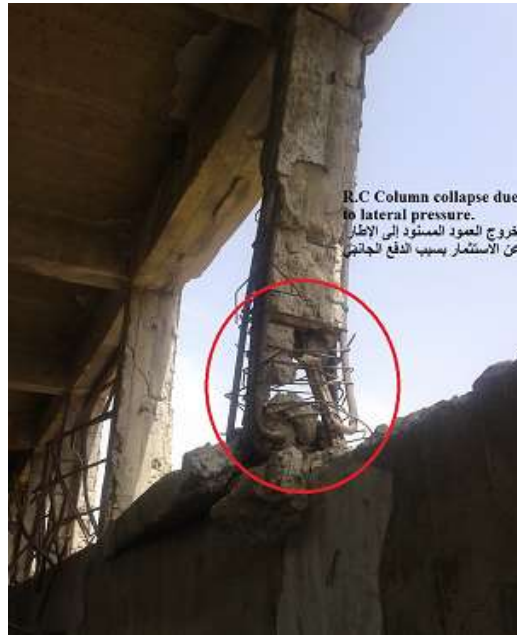
شكل /40/: تصدع وانهيار عقد ارتباط الأعمدة بالإطار
