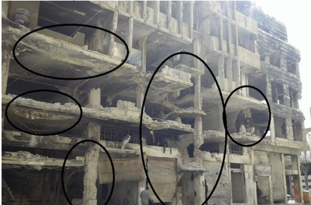
شكل /22/: المناطق المتضررة بشكل كبير من واجهة المبنى
