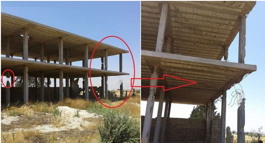
شكل /34/: الأضرار الحاصلة في المبنى الهيكلية
