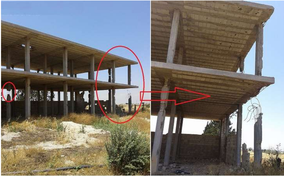
شكل /23/: الأضرار الحاصلة في المبنى الهيكلي
