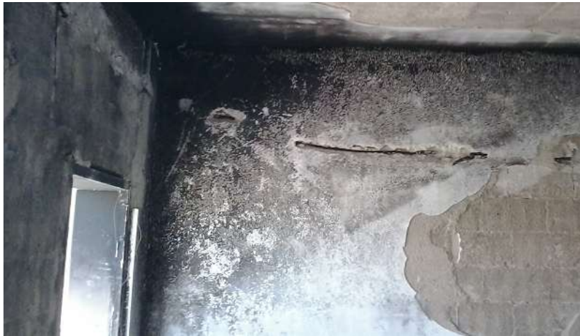
شكل /13/: الحريق الخفيف في المنشآت
